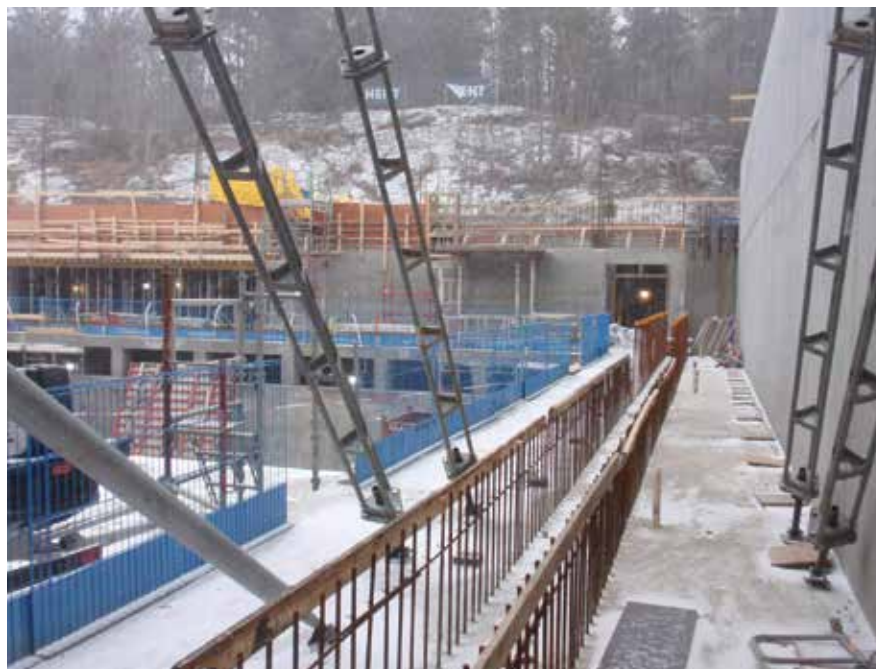
Produksjonen er kommet godt i gang på nåret og arbeidet med råbygget i badet fortsetter med økt bemanning og intensivitet.
